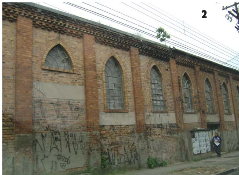
Fig 1. Pichações nas fachadas de imóveis reconhecidos como Patrimônio Cultural Campineiro. 1. Fachada posterior da Catedral. 2. Fachada da antiga Fábrica Lidgerwood
